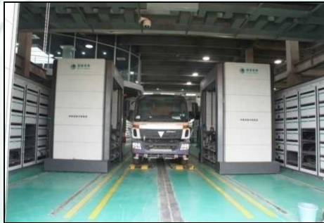
交換ステーション Battery Swap Station
