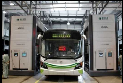
交換ステーション Battery Swap Station
