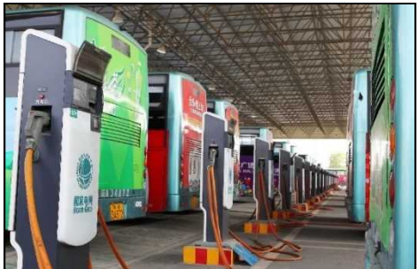
充電ステーション Charging Station
