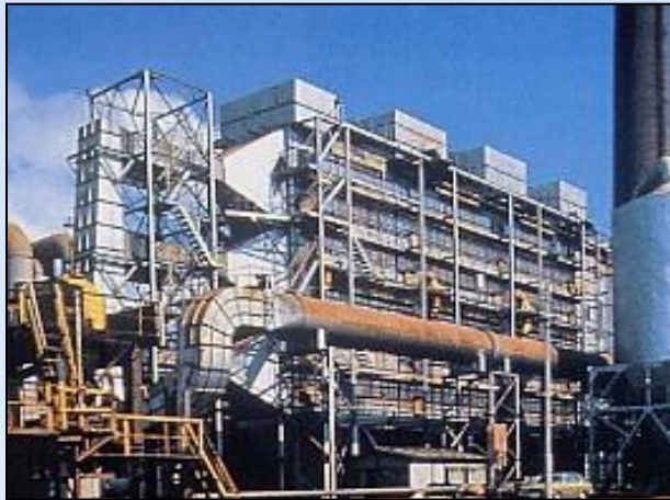
電気集塵機(煤塵除去)
