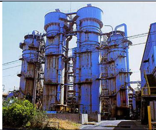
排煙脱硫装置(SOx)
