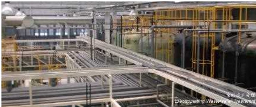
排水处理设备
