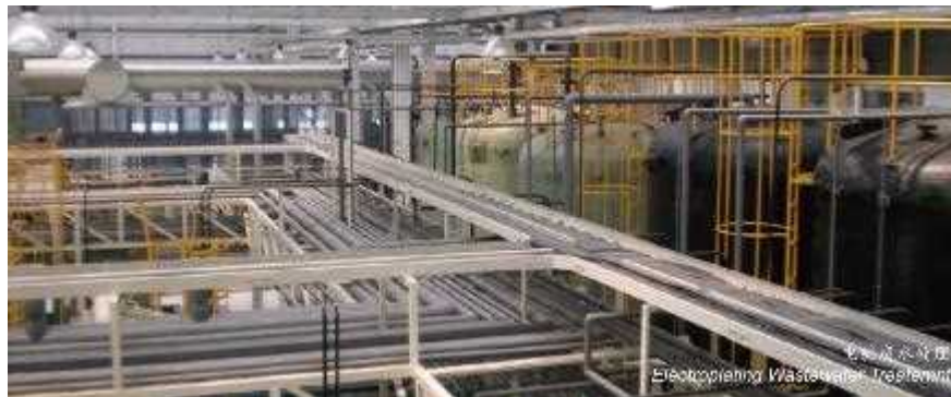
排水処理設備
