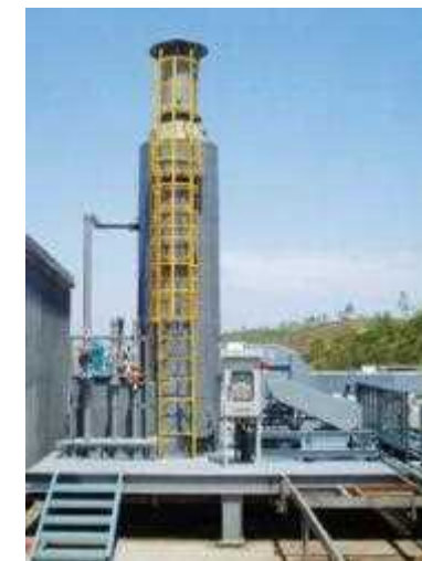
排気処理 Moretana脱硫設備
