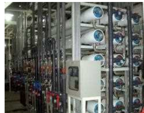
排水回収設備
