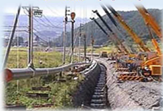
高压燃气干线
