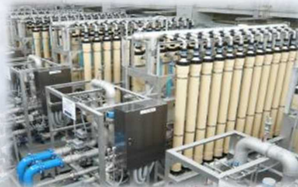
上水处理设施
