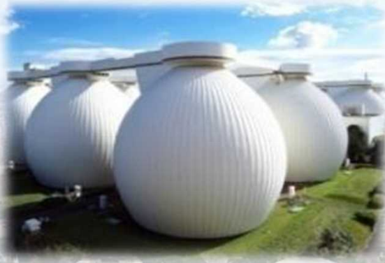
污泥处理设施
