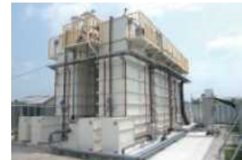
省エネ型MBR(膜分離活性汚泥)の パイロット試験装置
