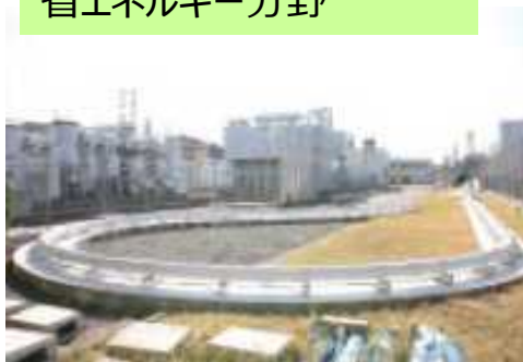
超電導ケーブルシステムの実系統連携運転
