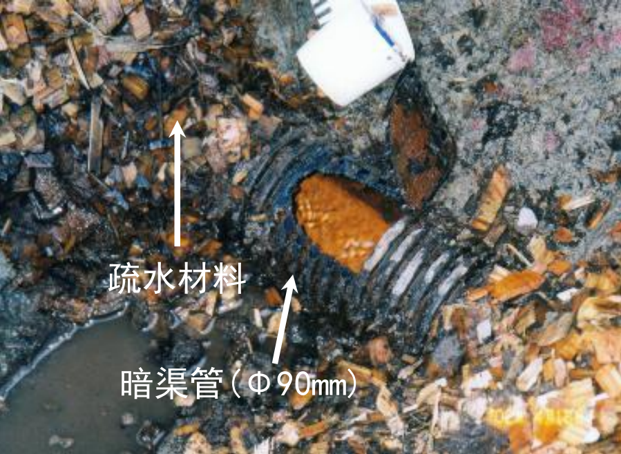
暗渠内铁沉淀发生物
