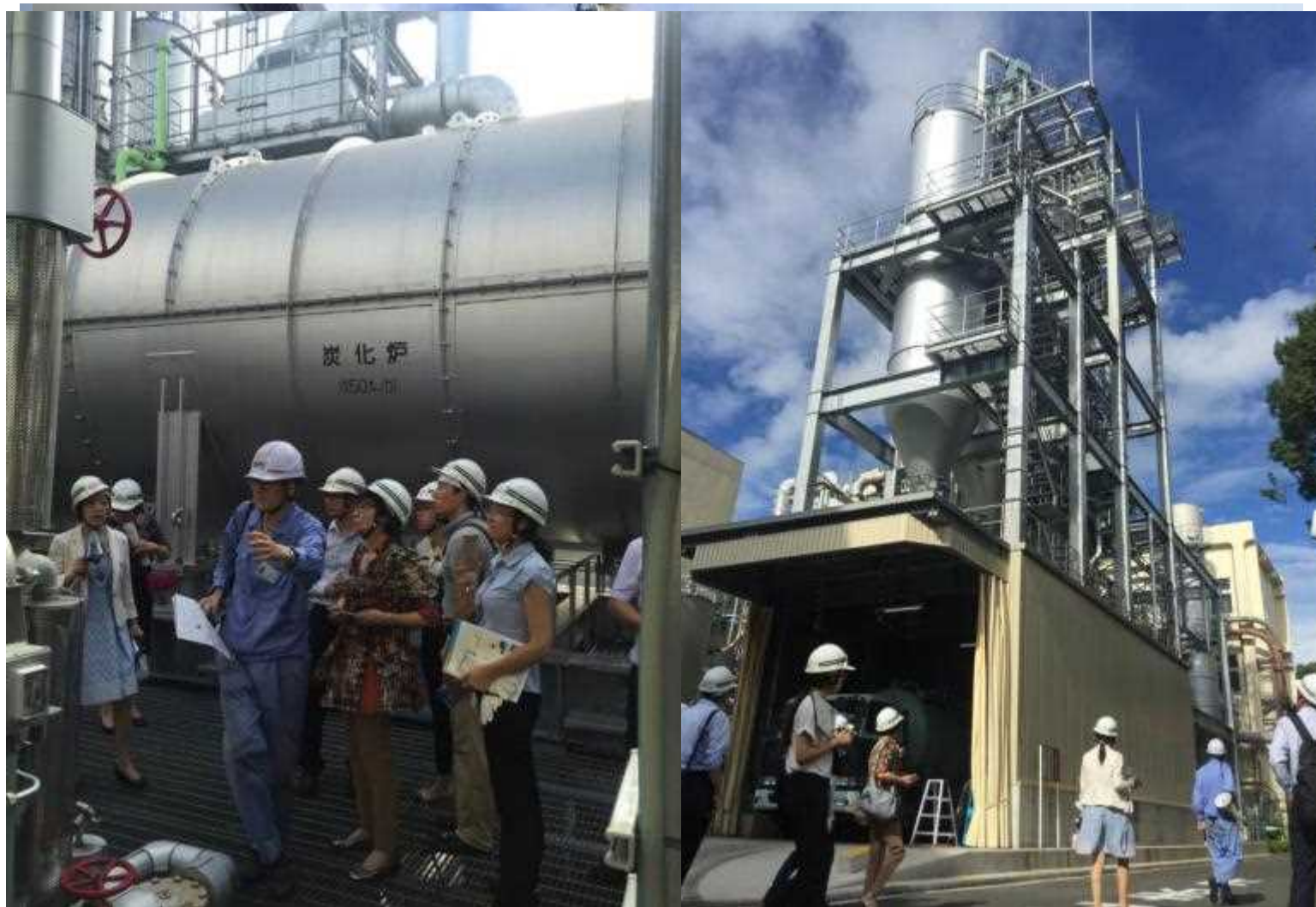
横滨南部污泥中心150ton/日×1套（2015年12月完工，2016年4月投入使用）
