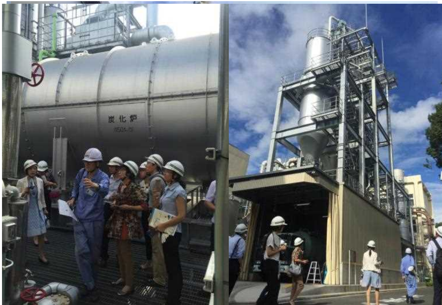
横浜南部污泥センター150ton/日×1系（2015年12月完成，2016年4月稼働開始）
