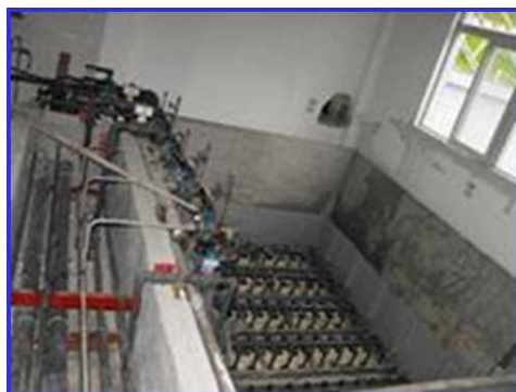
垃圾渗滤液处理厂
