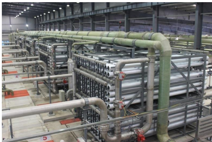
50,000 m 3 /d 海水淡水化设施（曹妃甸）
