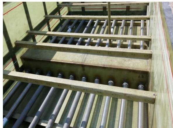
不锈钢过滤器安装状况
