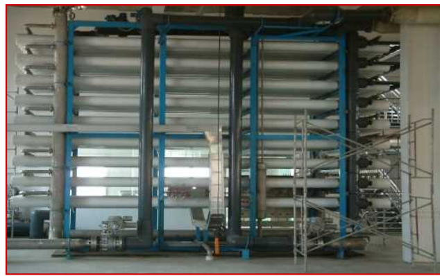
黄岛电厂 RO海水淡化工程
