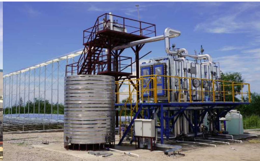
海南乐东太阳能光热低温多效海水 淡化装置，30吨/日
