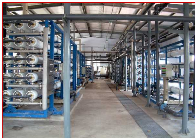
工業廃水処理再利用
