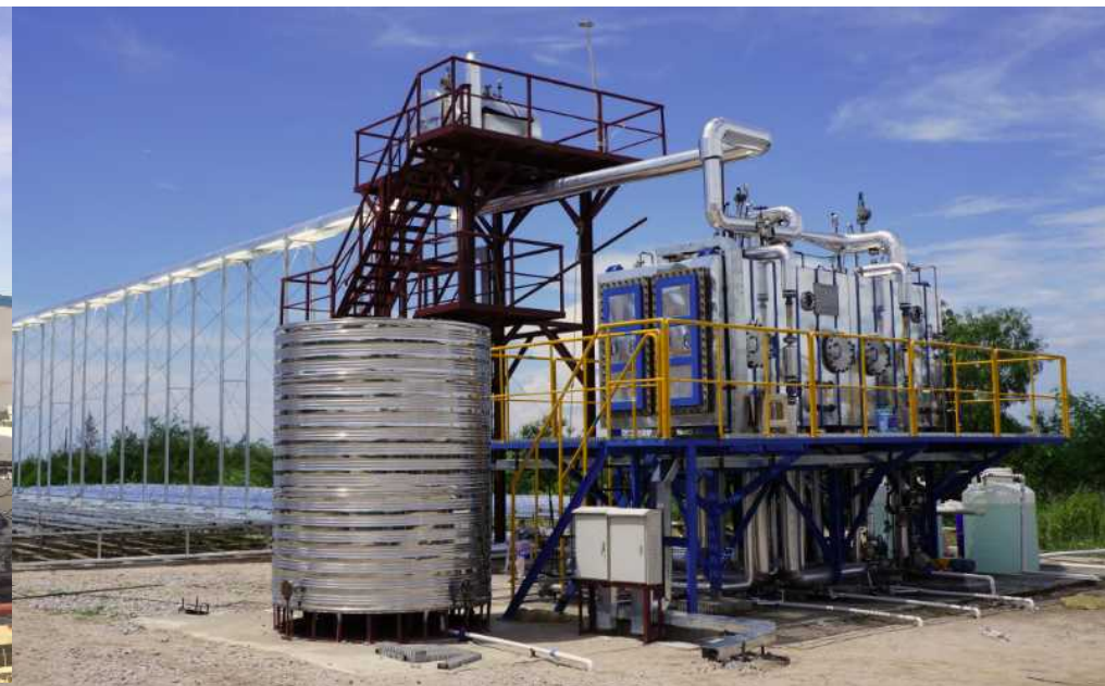
海南樂東の太陽エネルギー光熱多 重効用海水淡水化装置、30トン/ 日
