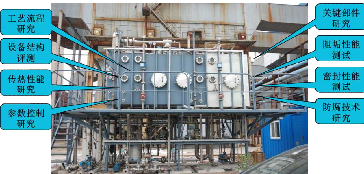
水平管式MED中間試験装置
