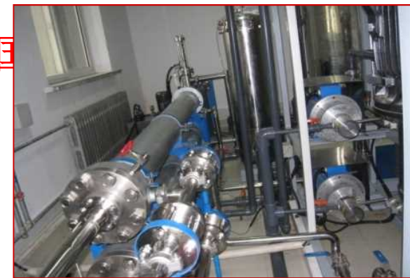
自主的に研究開発するエネルギー回生装置
