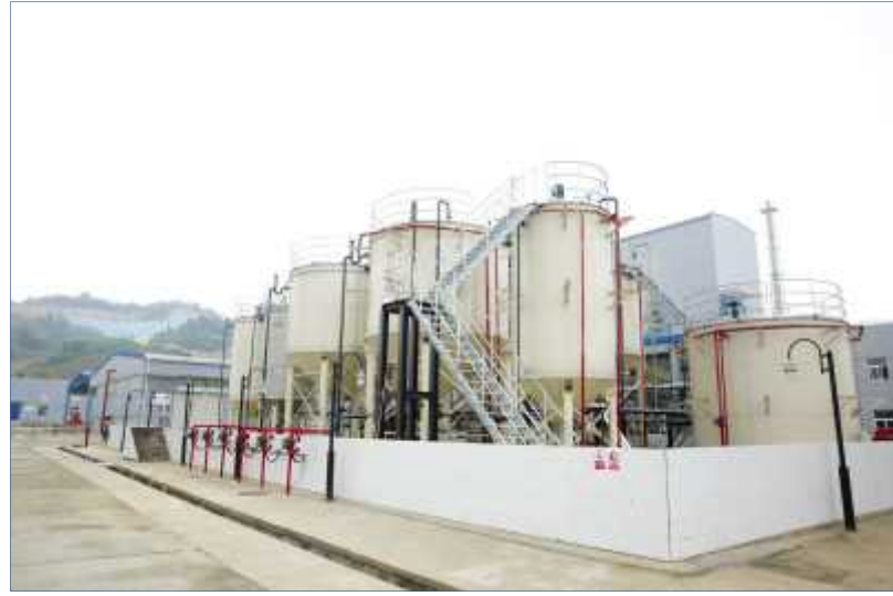
固废综合利用设施 固体廃棄物综合利用施設
