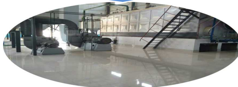
改造后高效环保煤粉锅炉 高効率エコ粉炭ボイラーに改造した後
