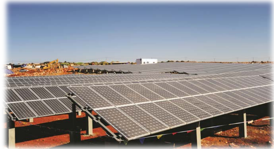
华能石林并网光伏电站
