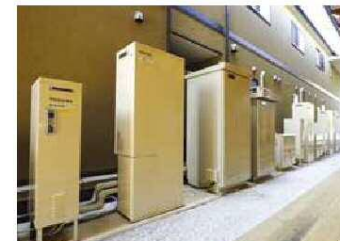
氢气实证住宅“东田H2” 燃料电池
