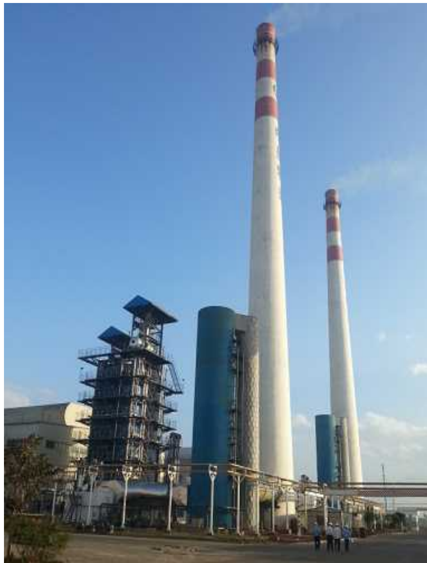
余热锅炉+脱硫
