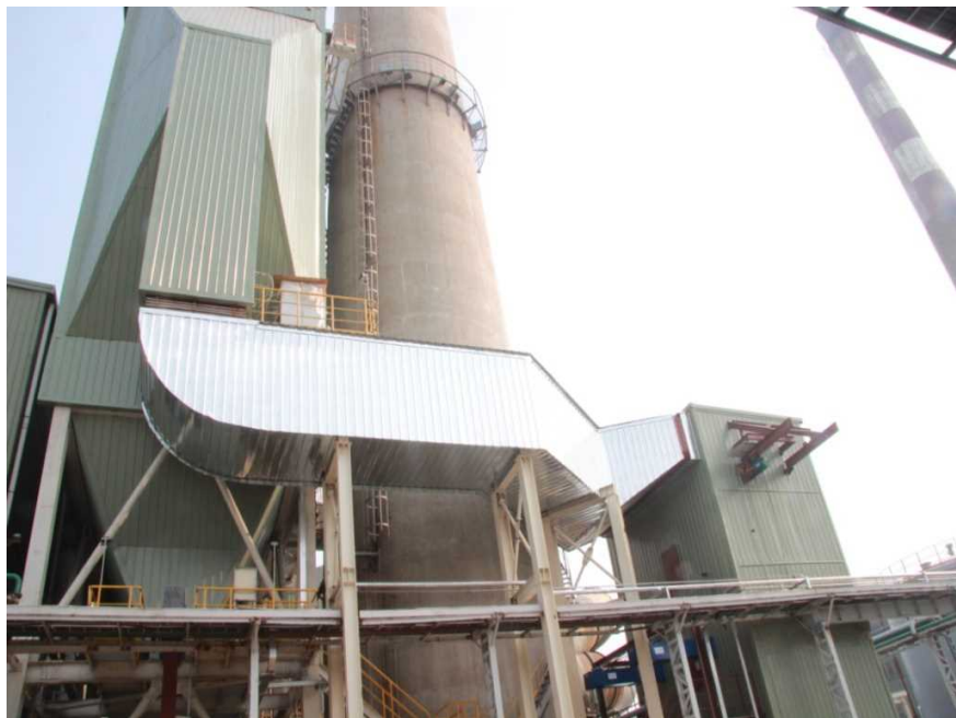
中国初の国際先進レベルに達した調質システム+高温 静電気脱塵+ SCR排気処理案件
