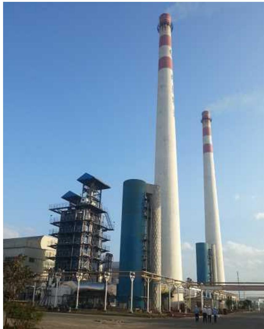
余熱ボイラー+脱硫
