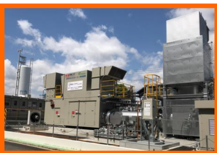
水素CGS エネルギーセンター
