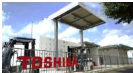
H2One-ST™ 可再生能源加氢站
