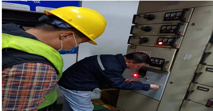
省エネ配電盤の改造 (20%電気代削減)
