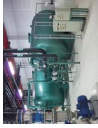
雨水浄化システム
